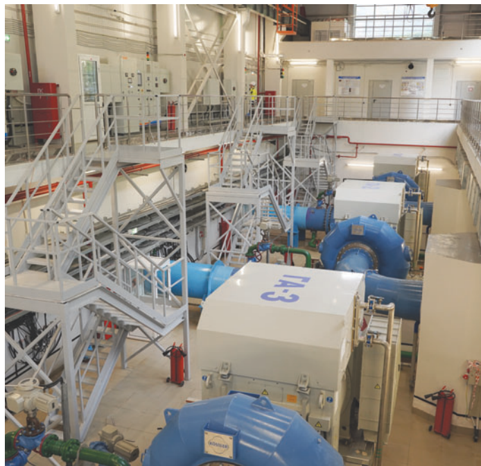
Машинный зал Верхнебалкарской МГЭС. Кабардино-Балкария
